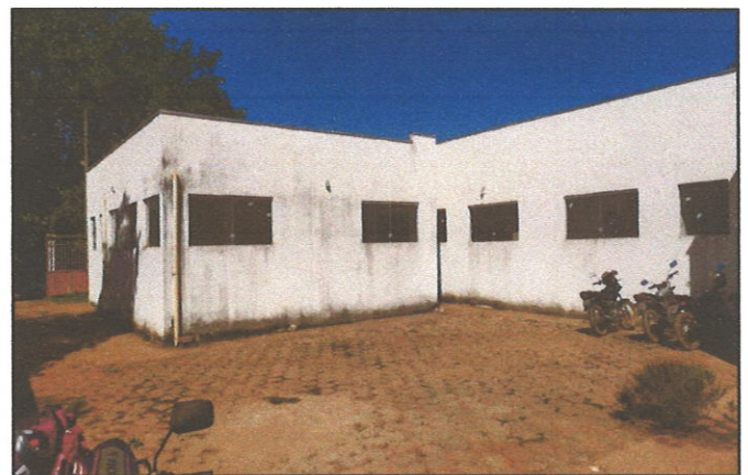
FIGURA 06 - Pintura externa danificada
