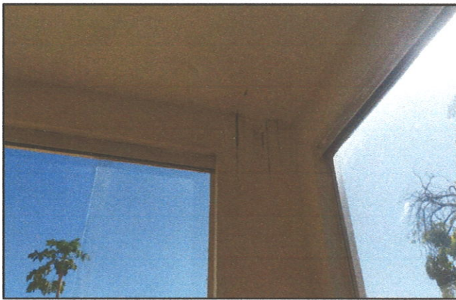
FIGURA 03 - Manchas nas paredes
