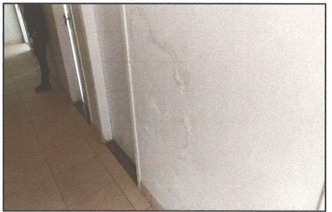
FIGURA 04 - Pintura interna danificada
